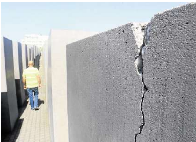
Dutzende der Beton-Stelen des Berliner Holocaust-Mahnmals weisen bereits Risse auf. Foto: dpa
